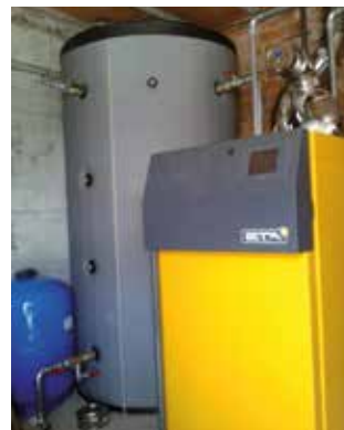
Caldera de biomassa
