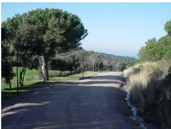
Detall de la cuneta fortament erosionada
