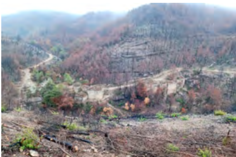
Construcció d'unes feixines per a la retenció del sòl a la zona de les Tines de la vall del Flequer. Font: Arxiu XPN
