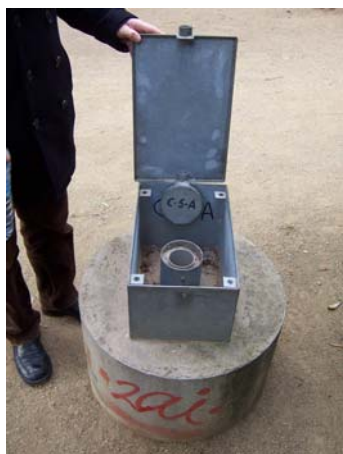
Fotografia 3.1. piezòmetre sobre un cilindre de formigó amb caixa protectora i part superior de l'anular cimentada.
